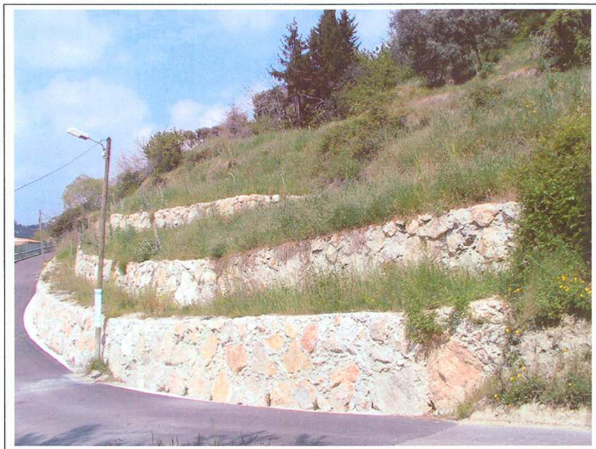
Photographie 8. Mur limitant le risque de glissement dans le quartier des Fontètes.
