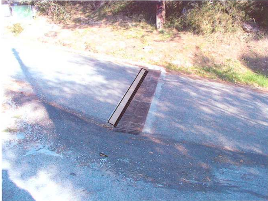
Photographie 5. Exemple de grille avec avaloir à construire au niveau du virage.
